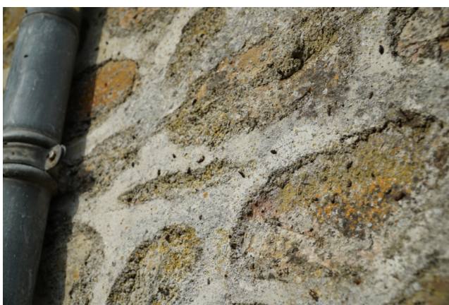
Figure 3: Traces de guano sur les façades de l'église
